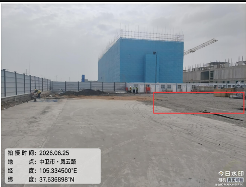
变电站站界南侧
